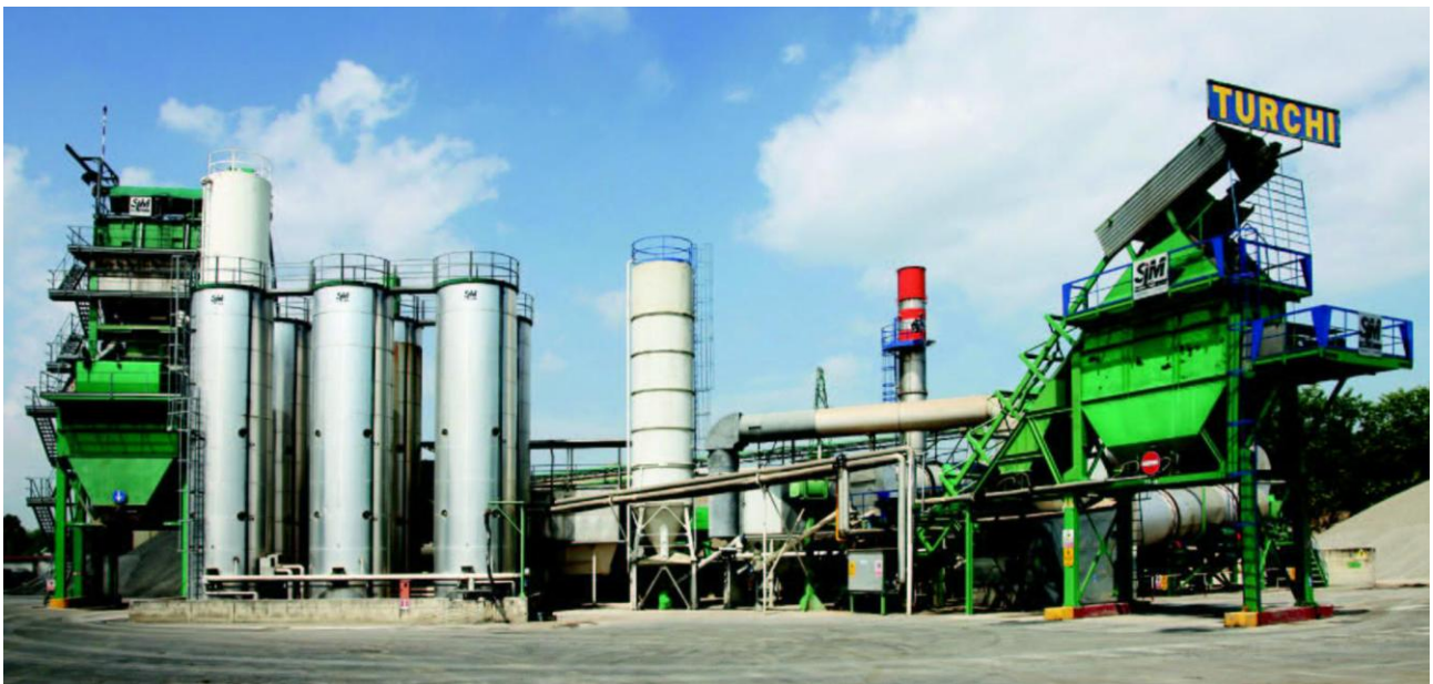
Figura 9: Panoramica degli impianti di confezionamento del conglomerato bituminoso
