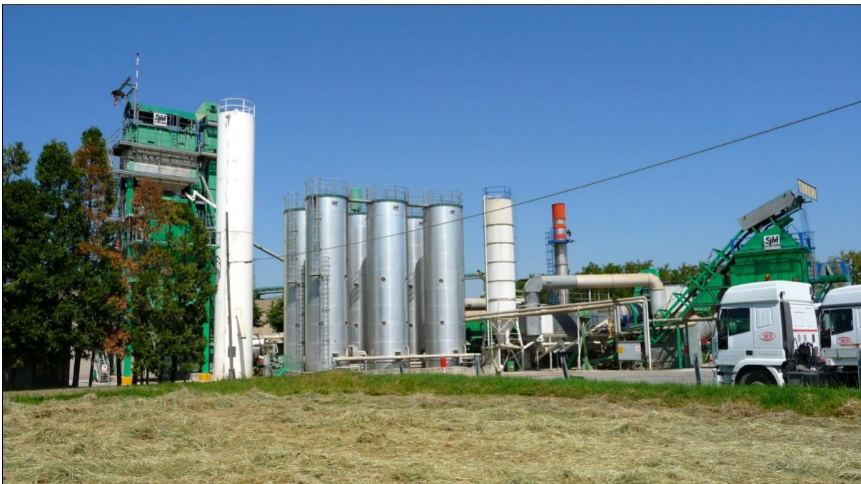
Figura 13: Silos di bitume e filler
