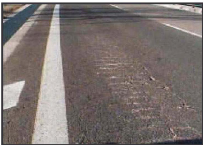
Figura 2: deformazione a pelle di coccodrillo
