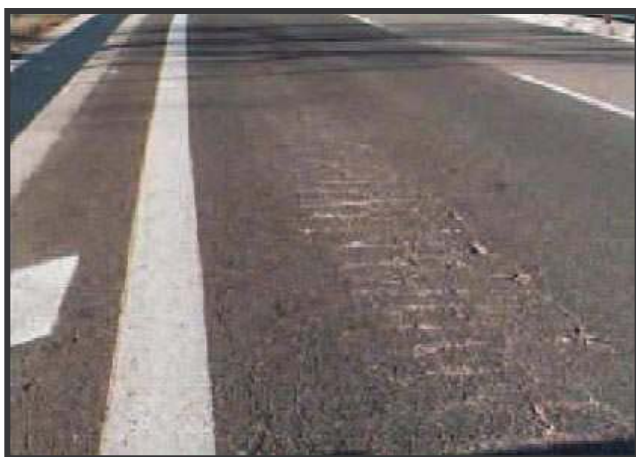
Figura 2: deformazione a pelle di coccodrillo
